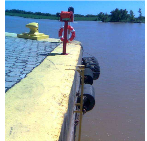
Estación de emergencia en muelle de ultramar, escala y defensas de muelle
