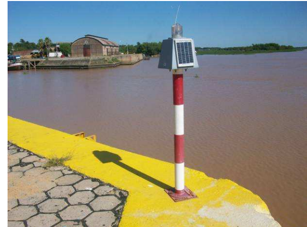
Baliza muelle mejorada con mayor superficie de paneles fotovoltaicos para lograr mayor autonomía. Instalada en 2011
