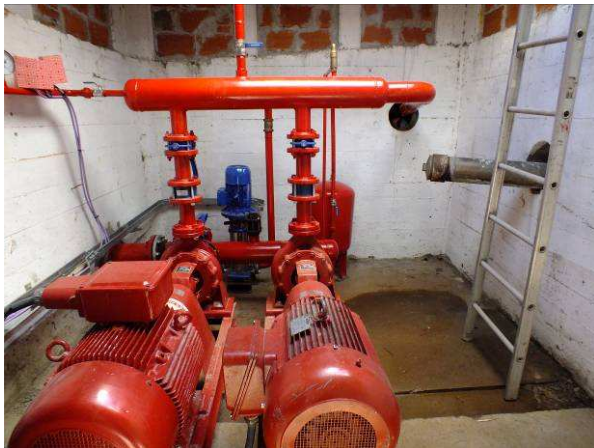
Equipos de bombeo red de protección contra incendios
